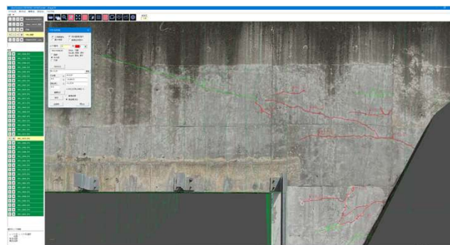
▶3D画像表示でひび割れを直接トレース※1
